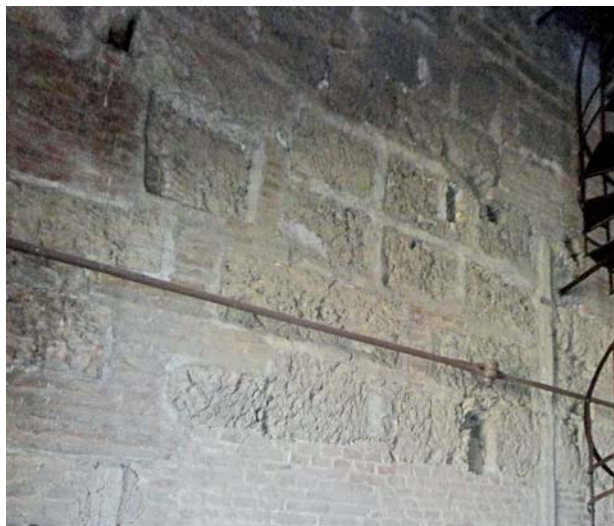
53. Palermo, chiesa del SS. Salvatore, catena posta in corrispondenza del vano in cui è ubicata la scala di accesso alla cupola.
